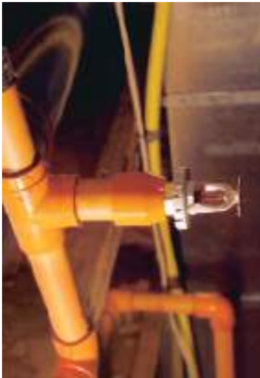
Impianto a pioggia (sprinkler)
